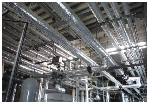
天井を走る配管。並べ方や分岐のさせ方に経験値の高さにじむ
